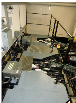
Abb. 10: Definierte Standfläche, Absturzsicherungen durch - Geländer mit Handlauf und Knieleiste sowie - Maske oberhalb Abräumer, zusätzlich - Not-Halt-Befehlseinrichtung („NOT-AUS“)
