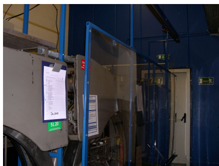
elektrisch verriegelte Schiebetür vor zwei Pinsettern
