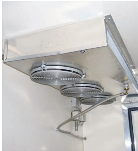
Abbildung 10: Sauberes Kühlaggregat in einer mobilen Kühlzelle
