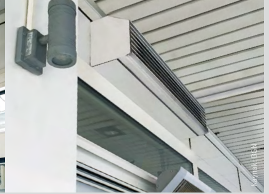
Isıtılmalı hava besleme sistemi (içeriden ve dışarıdan görünüm)
