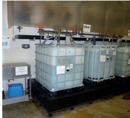
Abb. 5: Spritzschutz (Vorhang) über Flanschen und Pumpen
