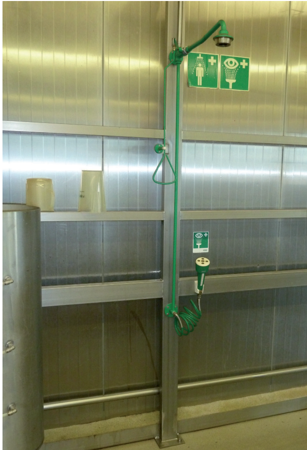
Abb. 9: Not- und Augendusche
