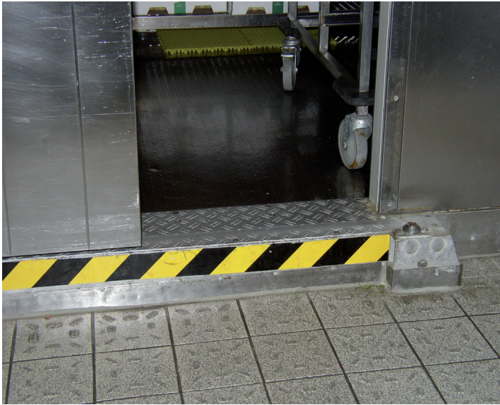
Abb. 8: Kennzeichnung von Stolperstellen
